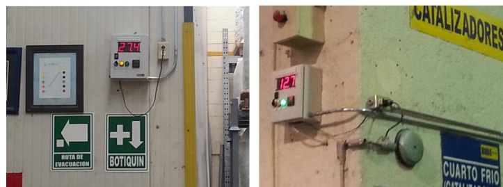
Figura 11 Vistas de dos monitores instalados en la planta.
