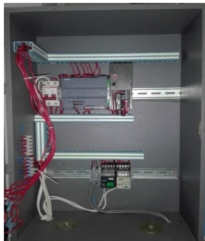
Figura 4 Gabinete de control.
