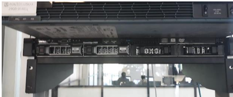
Figura 5 Servidor de almacenamiento.
