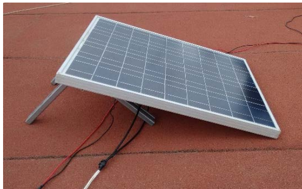
Figura 18 Panel fotovoltaico con estructura fija.
