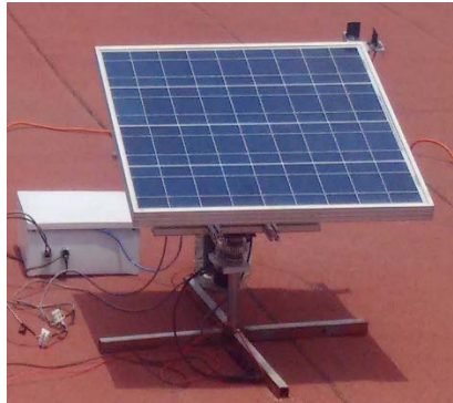
Figura 22 Seguidor solar de dos ejes.
