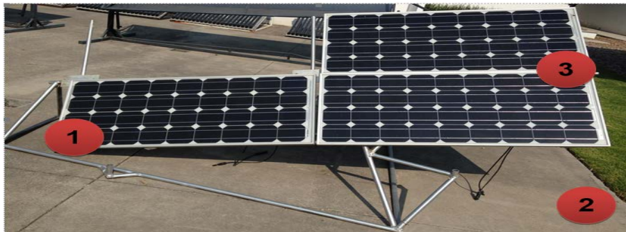
Figura 2 Estructura de los módulos fotovoltaicos.
