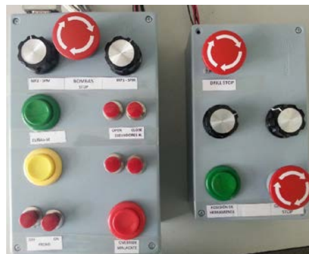
Figura 2 Tablero de mando.
