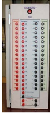
Figura 4 Vista lateral derecha del tablero didáctico.
