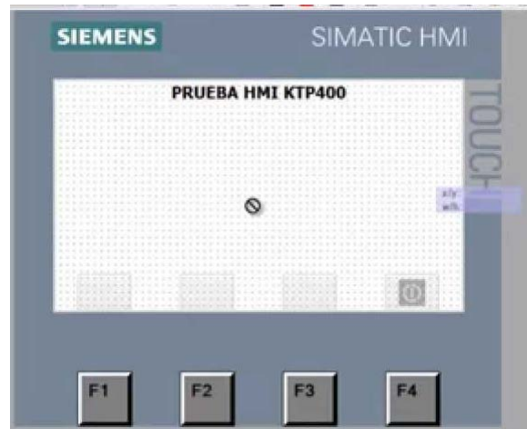
Figura 8 HMI Siemens KTP400.
