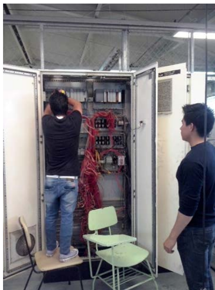
Figura 6 Tablero de tipo industrial para alojar circuitos de control y potencia.
