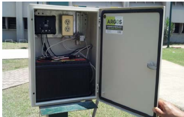
Figura 11 Gabinete de panel solar.
