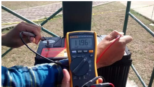
Figura 13 Pruebas de carga de batería y del sistema de panel solar.
