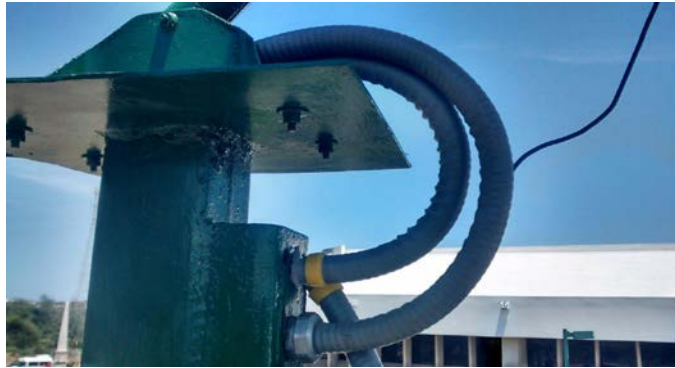
Figura 10 Instalación eléctrica del sistema fotovoltaico.
