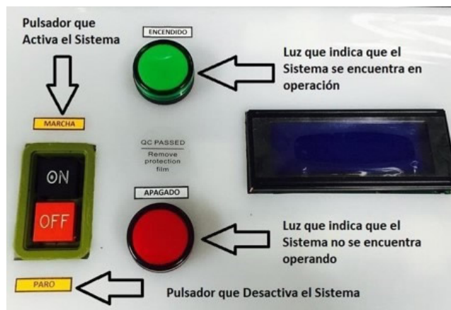
Figura 11 Interruptores para activar/desactivar el sistema.
