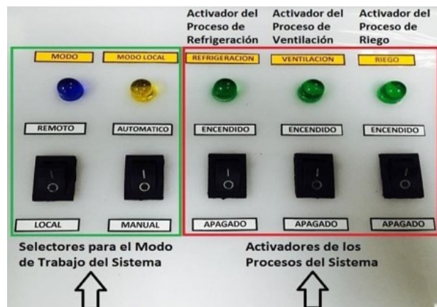
Figura 10 Interruptores para activar/desactivar el sistema.
