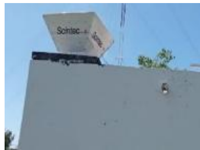
b) Equipo instalado.
