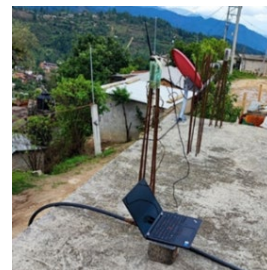
b) Transmisor instalado en PA.
