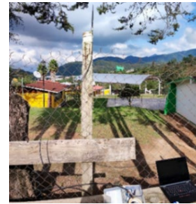
b) Transmisor instalado en IEBO.
