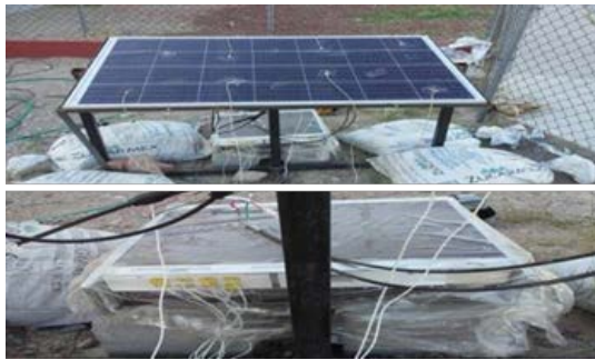
Figura 6 Sistema fotovoltaico aislado conectado al sistema de monitoreo.
