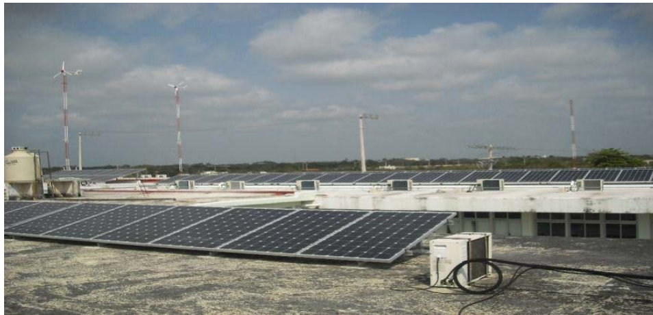
Figura 1 Sistema de generación fotovoltaico.
