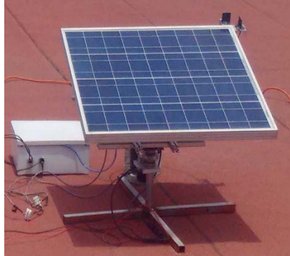
Figura 22 Seguidor solar de dos ejes.
