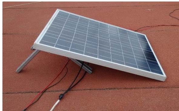
Figura 18 Panel fotovoltaico con estructura fija.
