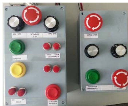
Figura 2 Tablero de mando.
