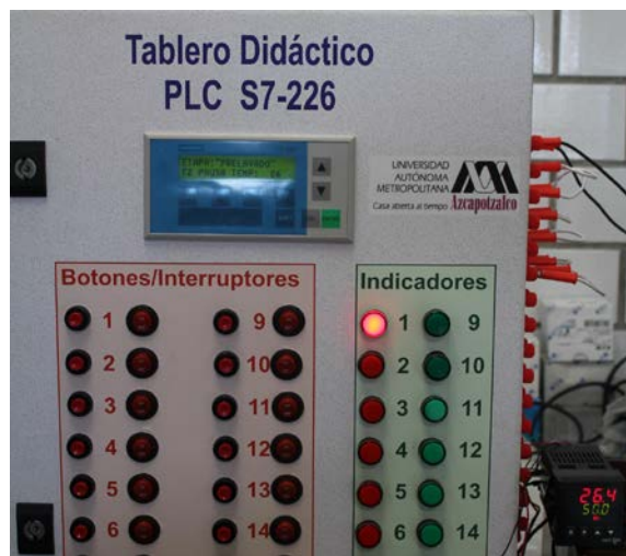
Figura 12 Control de lavado con monitoreo de temperatura mediante red 485.
