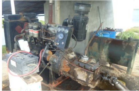
Figura 1. Bombeo actual en granja camaronera.
