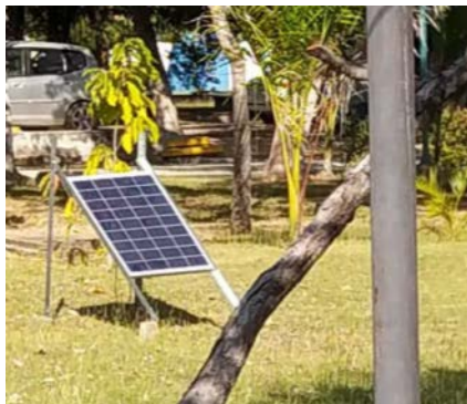
Figura 1 Panel solar PRO8512 instalado.
