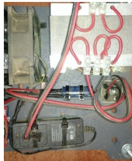
Figura 57 Conexiones de la fuente de alimentación.
