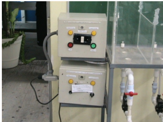
Fig. 3. Tableros de control.
